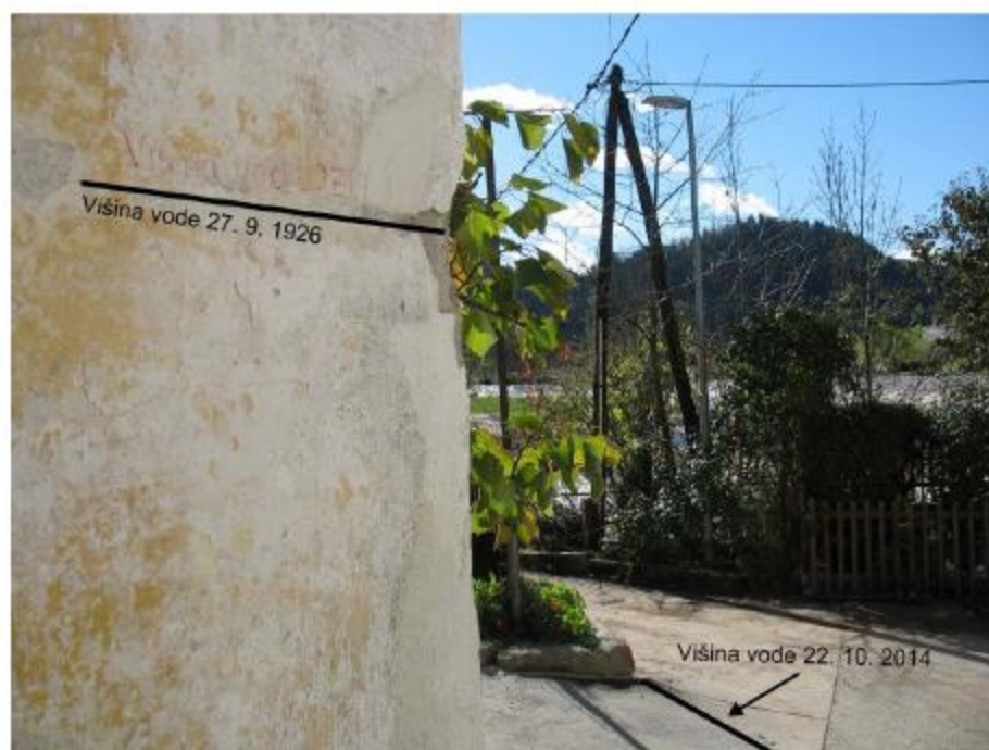
Slika 5: Na hiši je vidna oznaka najvišjega vodostaja Poljanske Sore 27. 9. 1926, na cesti pa je zarisana oznaka, do kod je segala voda 22. 10. 2014. (foto: Katja Košir).
